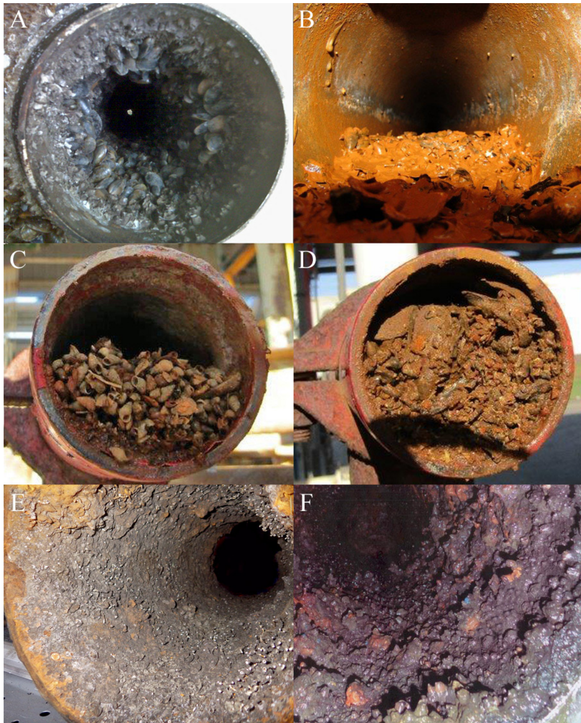
Fig. 6. Voorbeelden uit Nederland waarbij buizen en leidingen bij stationaire brandblussystemen zijn vervangen of gereviseerd vanwege problemen die verschillende organismen veroorzaakten. A, Mosselen vastgehecht aan de wanden van een buis. Dit betreft in zout water vooral de inheemse mossel Mytilus edulis , in brak water de Noord Amerikaanse brakwatermossel Mytilopsis leucophaeata en in zoet water de Ponto-Kaspische zebramosse Dreissena polymorpha en de de Ponto-Kaspische quaggamosse D. bugensis . B, Schelpresten hopen zich op en vormen een sedimentlaag waar zich organismen in kunnen vestigen zoals de Mexicaanse brakwater-strandschelp Rangia cuneata , die 10 cm groot kan worden. C, Ook enkele millimeters grote schelpen zoals die van het Zuid-Amerikaanse slakje cf Heleobia australis kunnen bijdragen aan verstoppingen in buizen, zoals hier bij een sprinkler systeem aangesloten op het bluswatermet. D, Roest en coating deeltjes in combinatie met schelpresten verstoppen gezamenlijk een buis. E, Buis met een beginnend rif van de Australische kalkkokerworm Ficopomatus enigmaticus . De kalkkokers kunnen tot ~70 cm hoge riffen vormen (Fig. 7). F, Buis waarvan het oppervlak bedekt is met zeepokken, waardoor een ruw oppervlak resulteert wat geschikt is voor de vestiging van een grote verscheidenheid aan soorten. (Foto's: Leenheer B.V.)
