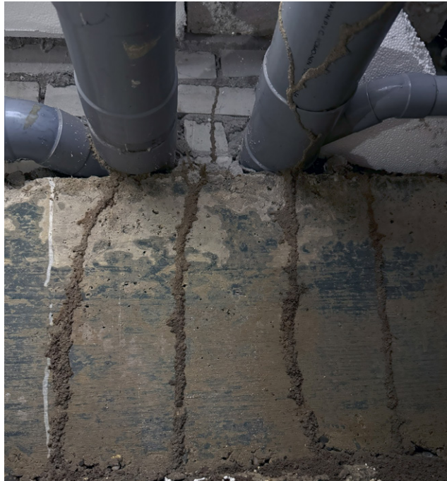
Figuur 2 Moddertunnels van Reticulitermes flavipes van de grond naar hout in een kruipruimte van een woning in Rijnsburg. Foto Anticimex.
